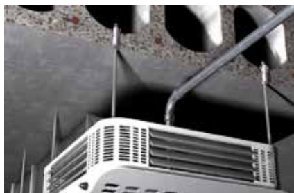
Unità di condizionamento su solai in calcestruzzo precompresso alveolare
