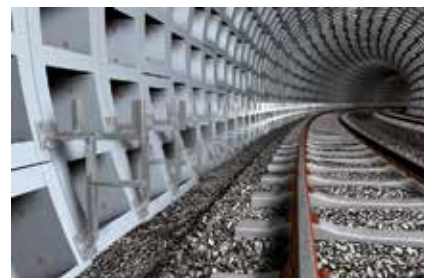
Installazioni in galleria
