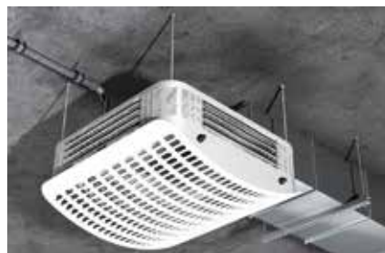
Unità di condizionamento
