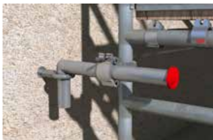
Ancoraggio Tubo A
