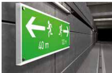
Segnali di uscita di emergenza in galleria
