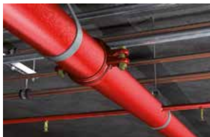
Impianti antincendio Sprinkler
