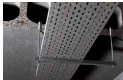
Supporti per cavi su solai in calcestruzzo precompresso alveolare
