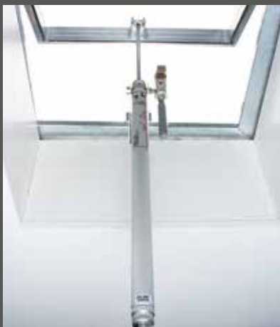
Su cupola con valvola termica
